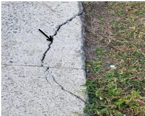
Fig:4.5 : Edge Breaking
