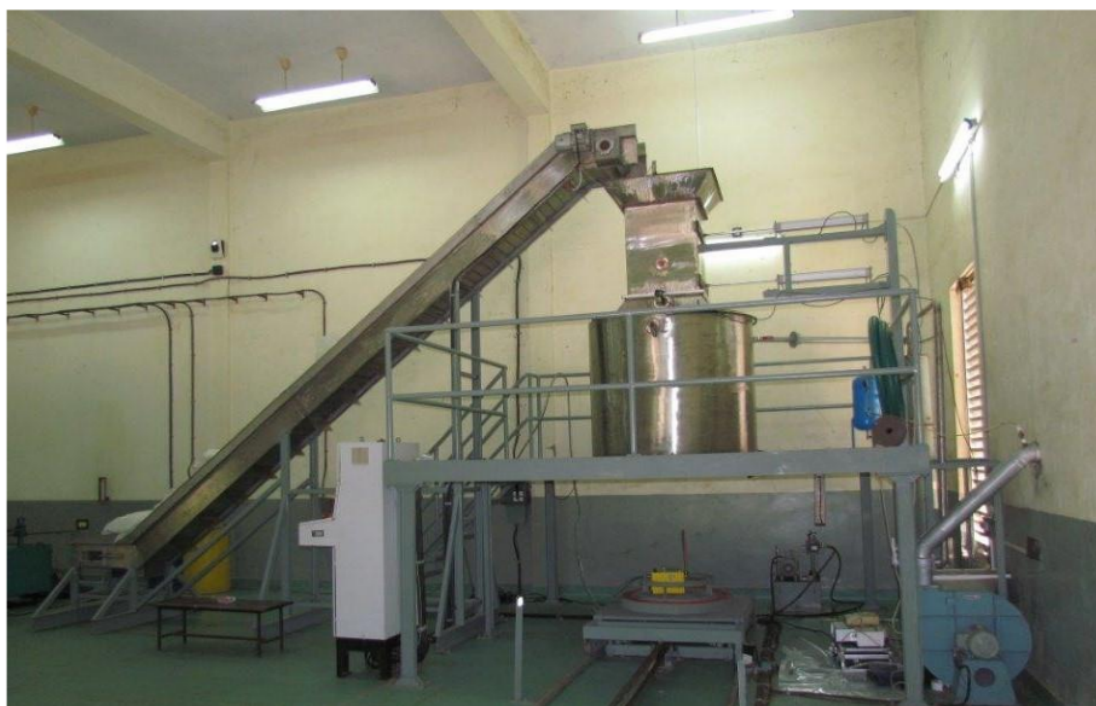
Fig: 2.4 : Melt densification Unit
