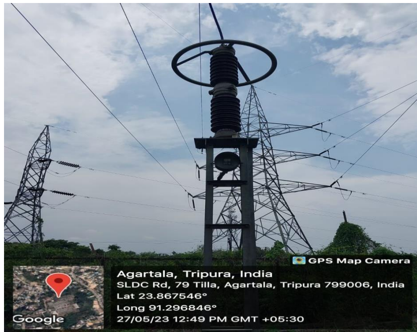
Fig: Lightning Arrester
